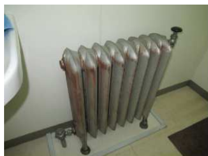
旧式の暖房設備
