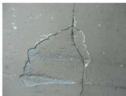
内壁ひび割れ
