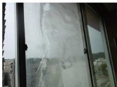
割れている窓
