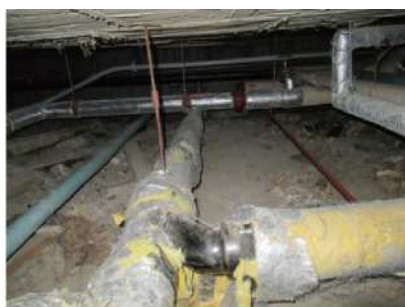
設備配管の劣化
