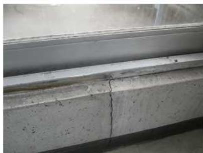
窓廻りの老朽化と 窓下のひび割れ
